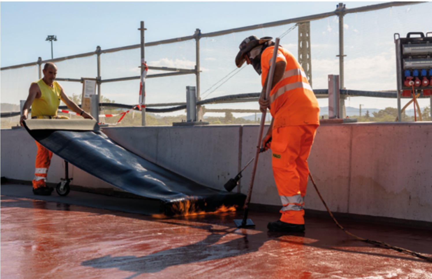
Auf die erste Abdichtung aus rotem Kunststoff (Epoxidharz) werden als zweite Schicht Dichtungsbahnen aus Polymer-Bitumen aufgebracht.
