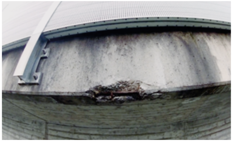
Betonabplatzung an der Brücke aus Sicht der Drohnenkamera.
