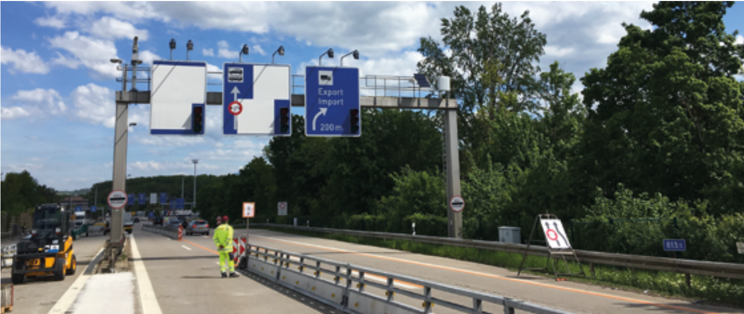
Die bestehende Signalbrücke muss ersetzt werden, um genügend Raum für die Fahrspuren zu schaffen.
