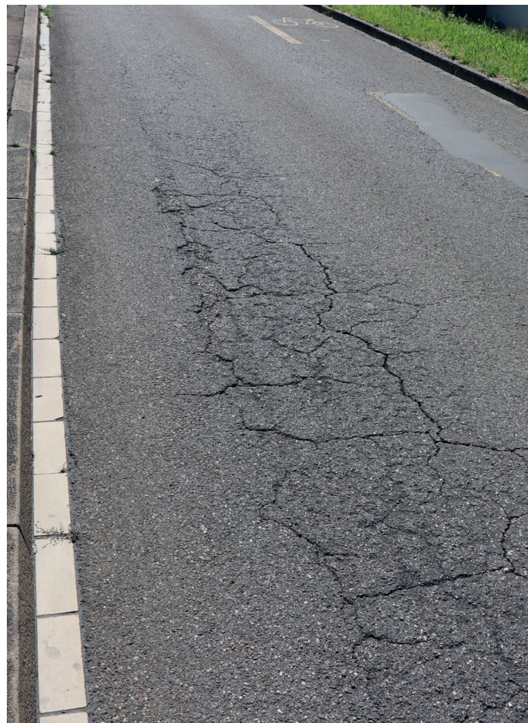
Beschädigung am Strassenbelag.
