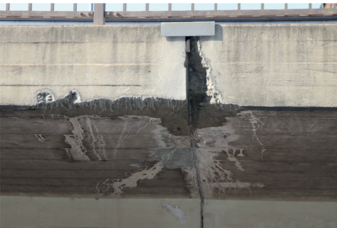
Betonabplatzung an der Unterführung Lagerhaus.
