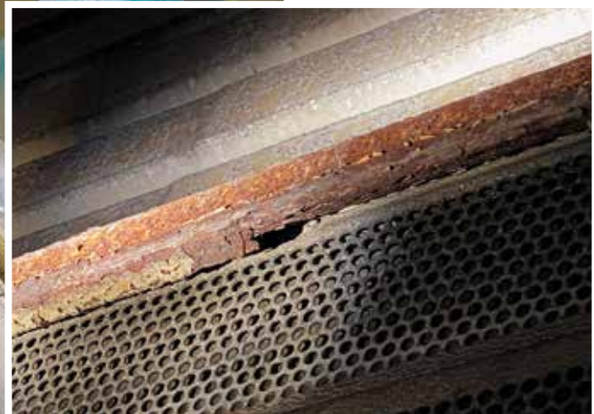
Korrosionsschaden am Profil einer Schallschutzwand.
